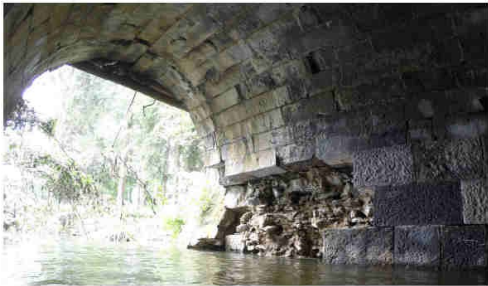
Vue des dégâts au-dessus de la ligne de flottaison – Affouillement 3 en rive gauche – Amont
